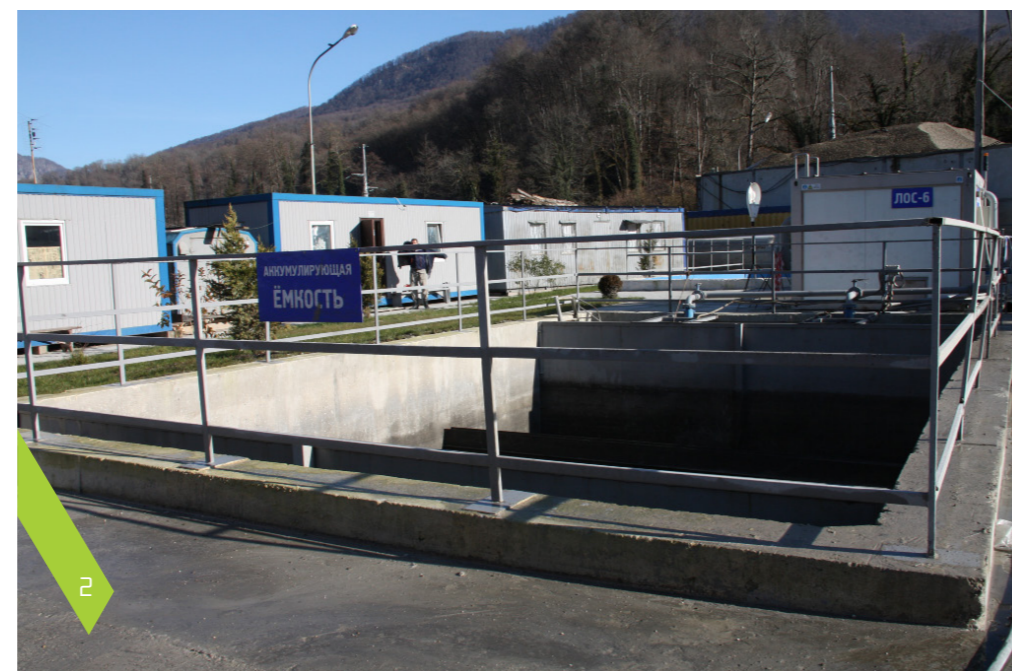
2,3,4 Резервуары для ливневых вод
