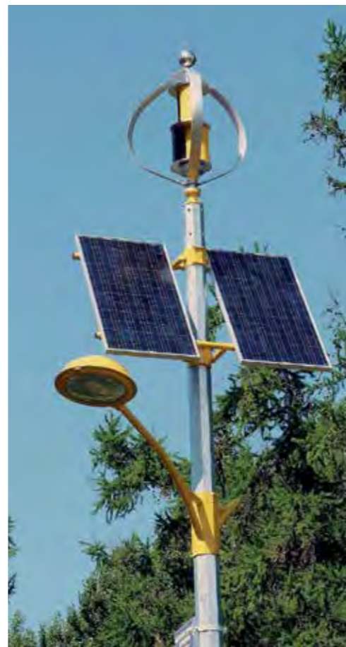
Пример автономной опоры с ветрогенератором, установленной в «Олимпийском парке» Autonomous lamp with a wind generator in the Olympic Park
