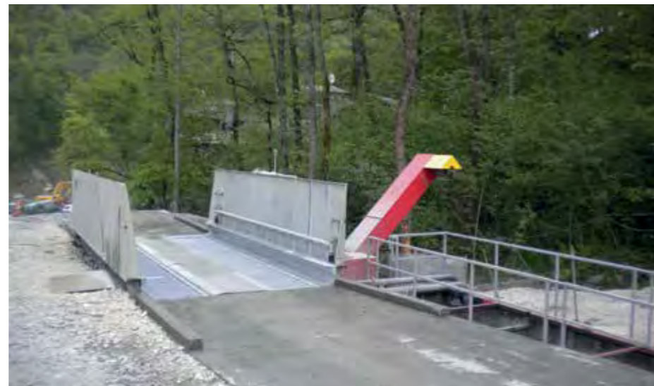
Пункт мойки колес автотранспорта с системой оборотного водоснабжения Wheel cleaning point for vehicles using a water recycling system
