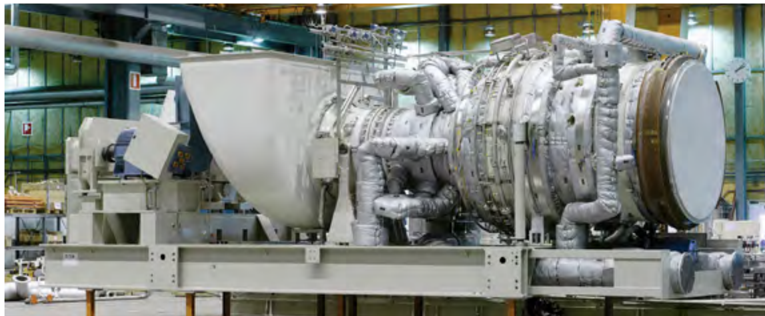
Вид турбины, установленной на Туапсинском нефтеперерабатывающем заводе
