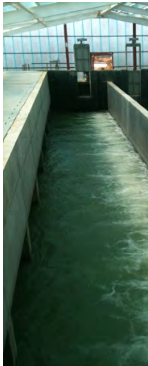
Очистные сооружения канализации в Адлерском районе
